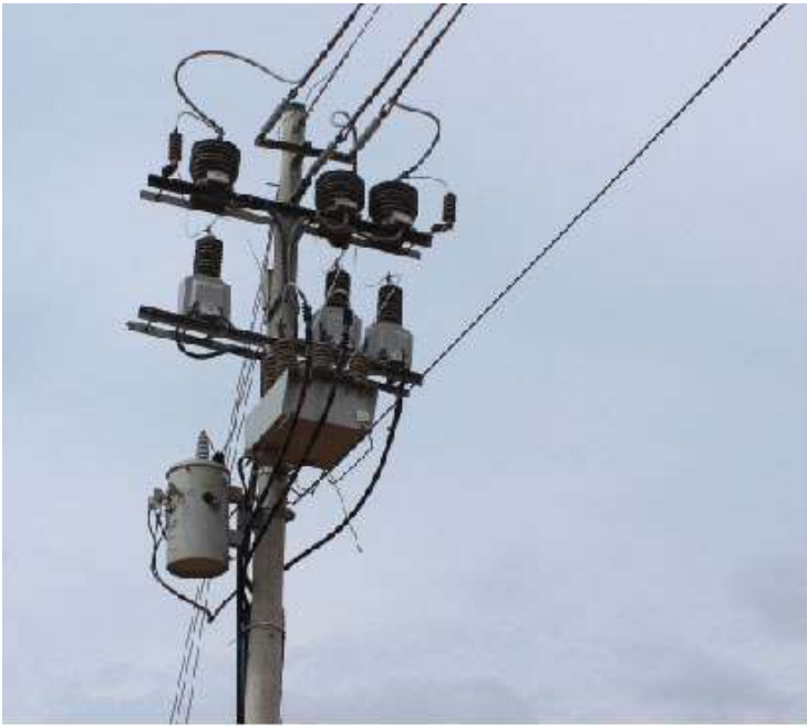
Red de distribución de energía
