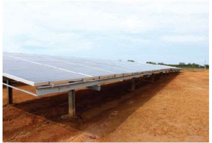
Planta Fotovoltaica Sarigua
