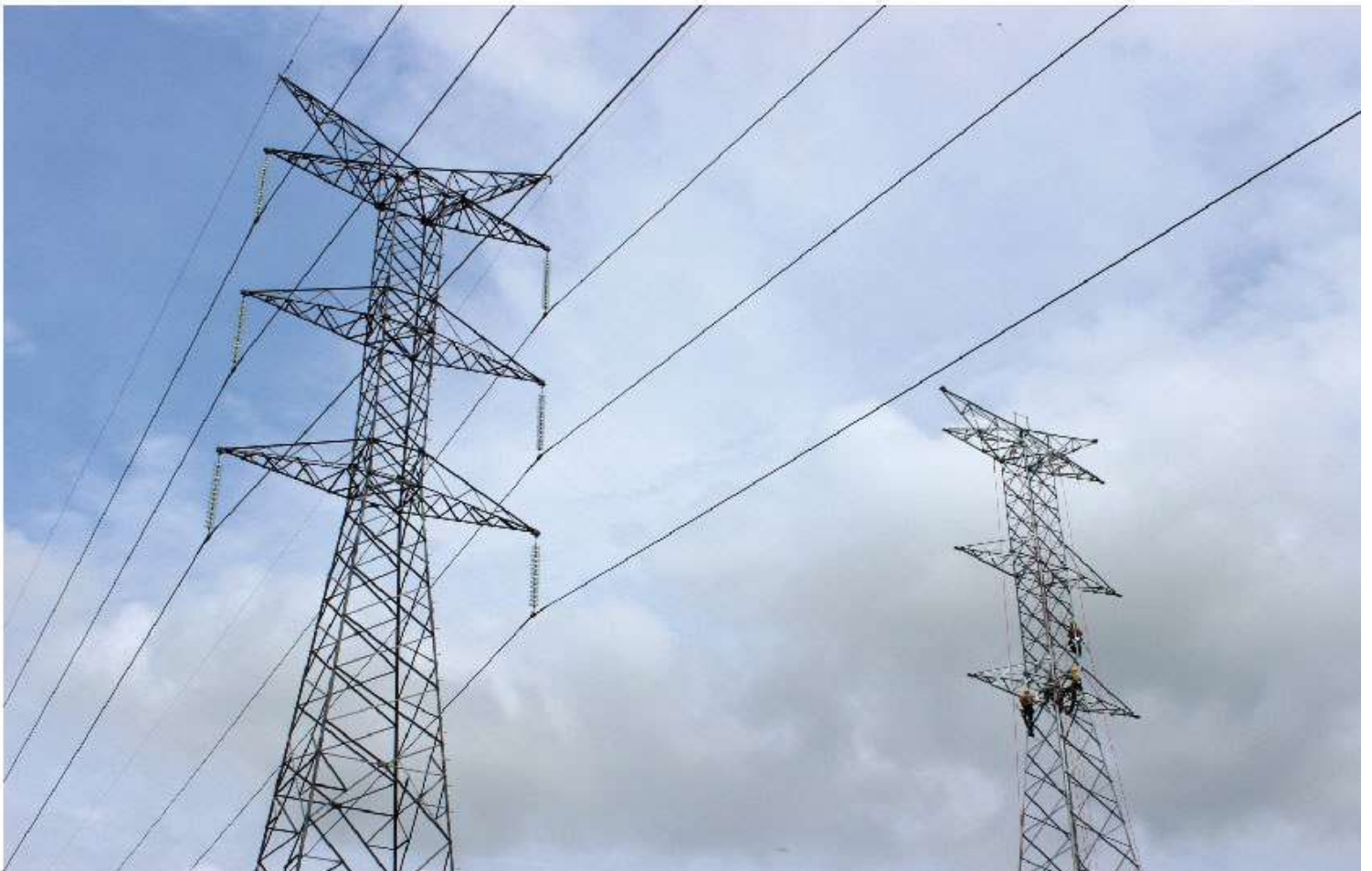
Tercera línea de transmisión eléctrica
